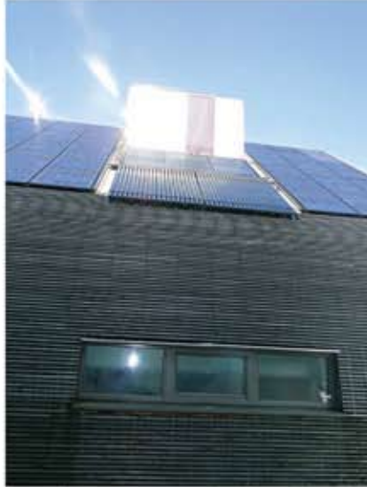
Yan cephe, evin enerji ve sıcak su ihtiyacı fotovoltaik panellerle karşılanıyor.
